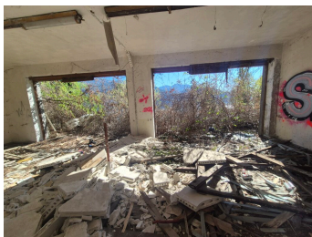
Und überall Bauschutt.
