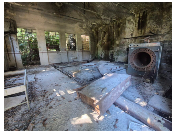
Das Innenleben der Heizung.
