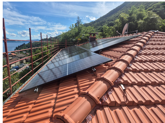
... und auf dem Dach sind die Solarpanels montiert
