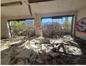
Und überall Bauschutt.
