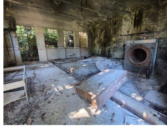
Das Innenleben der Heizung.
