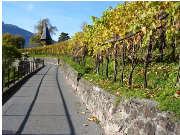
Der schmale St. Mamertenweg: 1983 wurden die Fugen zwischen den Steinen ausgemörtelt
