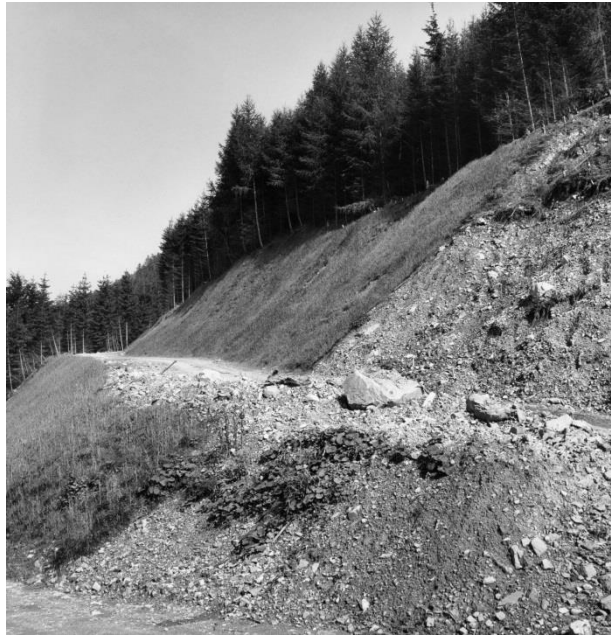
Viele Forststrassen im steilen Gelände sind bereits nach ihrer Errichtung erosionsanfällig und bedingen einen hohen Unterhalt
