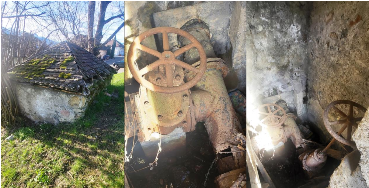
Links: Das verlotterte Häuschen an der Runkelsstrasse in Triesen. Mitte und rechts: Rostiges Innenleben des Häuschens.
