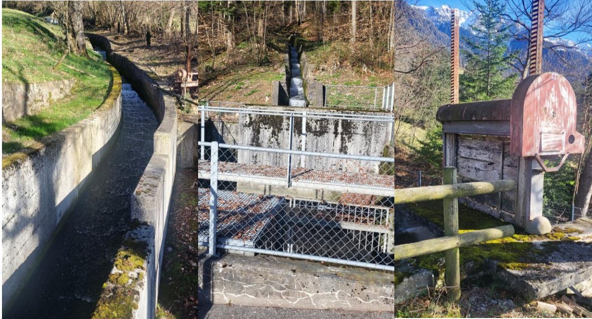
Dem Speicherbecken auf Letzana zugeführte Gewässer (links und Mitte); Alte Schiebereinrichtungen der Wasserzufuhr zur Druckleitung.
