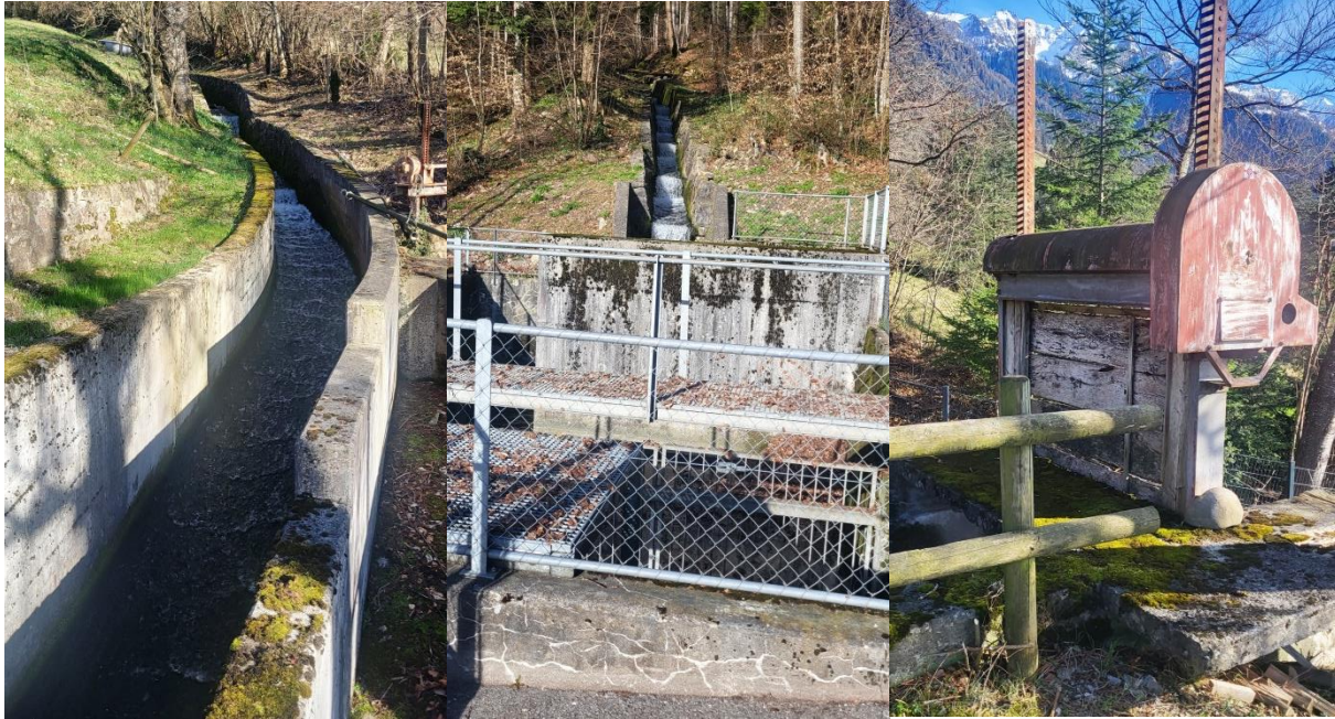
Dem Speicherbecken auf Letzana zugeführte Gewässer (links und Mitte); Alte Schiebereinrichtungen der Wasserzufuhr zur Druckleitung.
