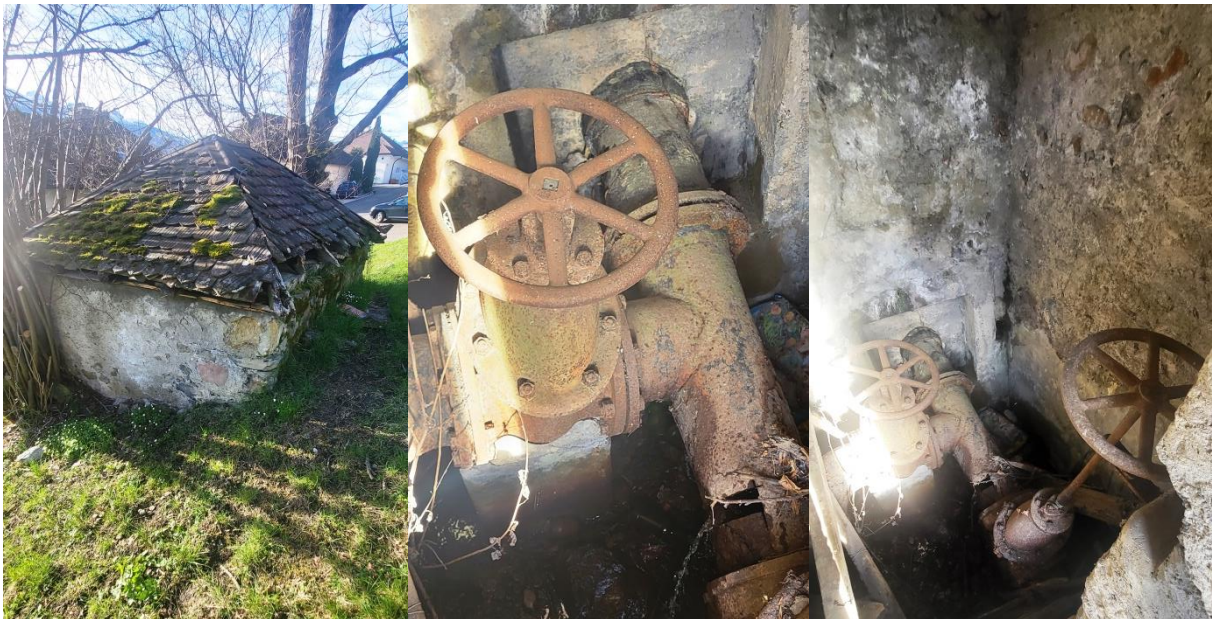
Links: Das verlotterte Häuschen an der Runkelsstrasse in Triesen. Mitte und rechts: Rostiges Innenleben des Häuschens.
